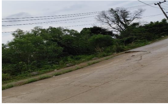
Gambar 1.2 Kerusakan Jalan Rigid (sumber: Dokumentasi lapangan, 2025)
