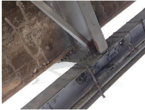
Gambar 1. Karat pada Sambungan Jembatan
