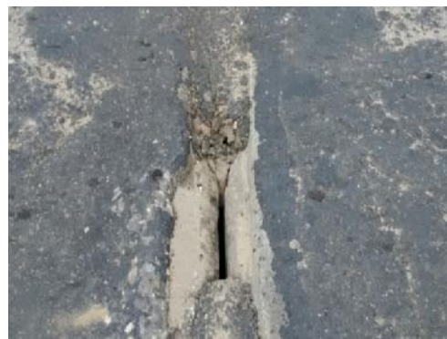
Gambar 3. Hasil Pengecekan Kerusakan pada Sambungan Ekspansi Aspal sebagai Penutup Jembatan pada Sambungan Ekspansi sedang Terkelupas
