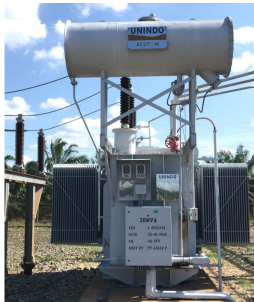
Gambar 3. 3 Transformator Daya Balam Substation (Sumber : PT. Pertamina Hulu Rokan)
